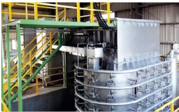
鹿島市衛生センター @ 茨城 15m 3 /日 処理
