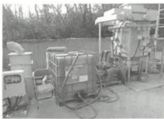
デモプラント(⑥から酸化分解室、循環タンク、触媒排気処理装置)。今後、車両に搭載して出張デモも行う
